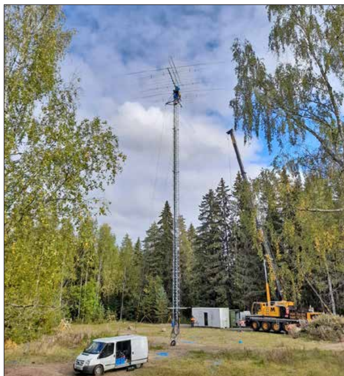
Masto valmiina yhteyksiin. Kuva: Puolustusvoimat.
